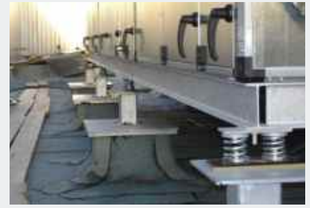
Installation VMC en toiture
