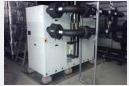
Unité de Refroidissement intérieur
