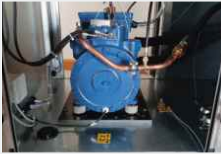
Isolation d'un compresseur à piston avec Isotop MSN-DAMP
