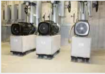
Isolation de pompes avec masse supplémentaire
