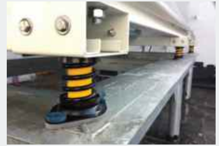
Refroidisseur installé sur toit
