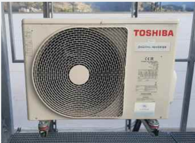
Appareil de climatisation en extérieur sur support mural
