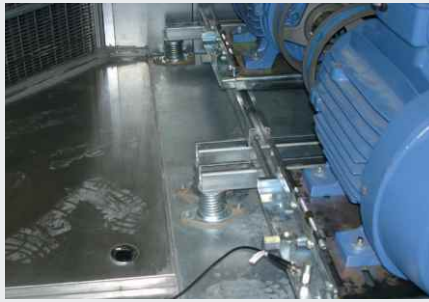
Isolation de ventilateurs à entraînement par courroie
