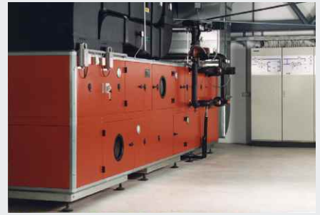
Système VMC placée en sous-sol
