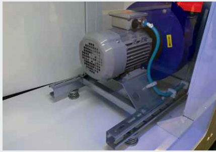
Ventilateur radial dans une installation VMC
