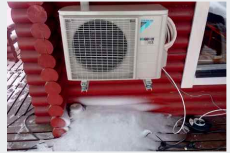
Unité extérieure d'une pompe à chaleur sur support mural
