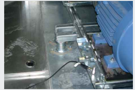
Isolation d'un appareil de climatisation avec Isotop SD et Isotop FP/K
