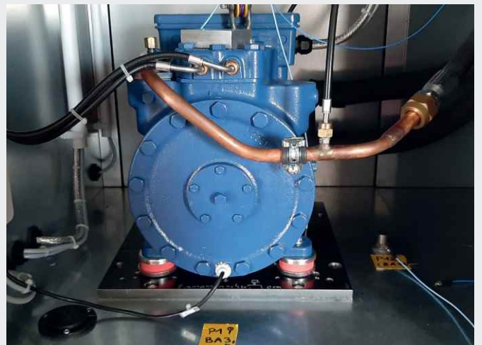
Isolation d'un compresseur à piston avec Isotop Compact
