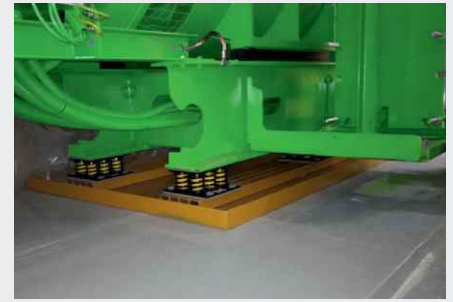
Grande centrale de cogénération soumise à de nombreux cycles de marche/arrêt
