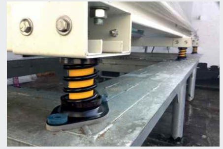
Refroidisseur installé sur toit
