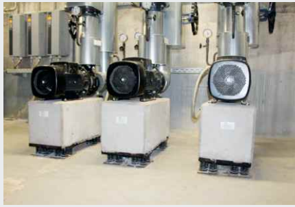
Isolation de pompes avec masse supplémentaire
